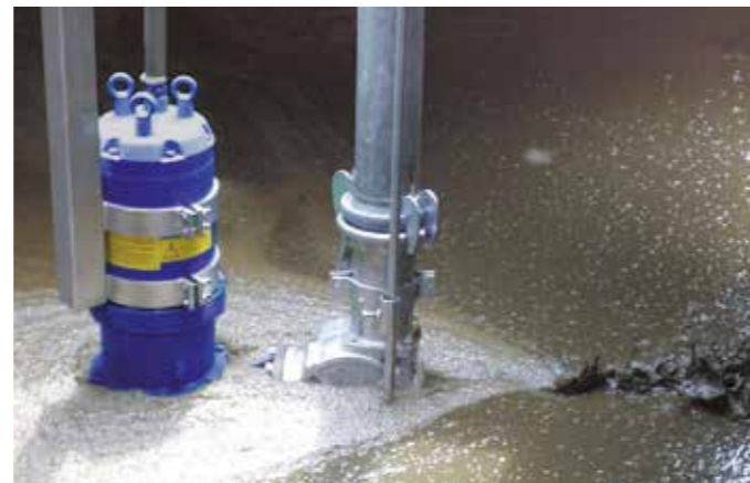
Beschickung der Anlage mit einer speziellen Tauchmotorschneidpumpe
